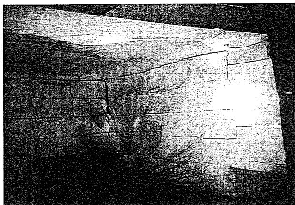
Bild 5 | Erosionserscheinung an einer Ofenauskleidung durch Gasgeschwindigkeit. Modulauskleidung aus CMS-Faser.
